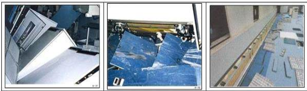
[그림 1] 정보통신설비 지진 피해 사례(서버랙 전도, 이중마루 붕괴 등)
