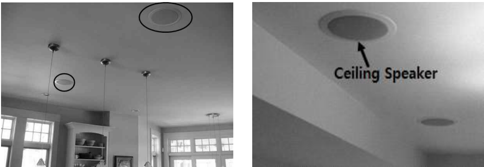
[그림 3-23] Ceiling Speaker 설치 사례(예시)
