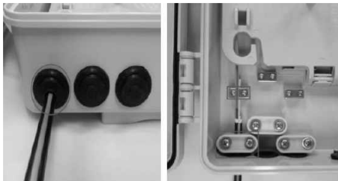
[그림 4-66] 광단자함 설치 (② 인입 광케이블 고정)
