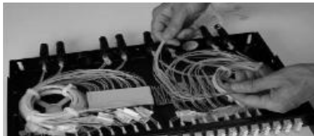
[그림 4-62] FDF 설치 (⑦ 케이블 연결)
