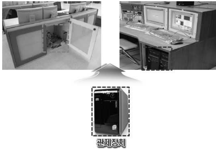
[그림 4-118] 관제장치 설치
