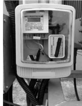
< 전력량계 설치 사진 >
