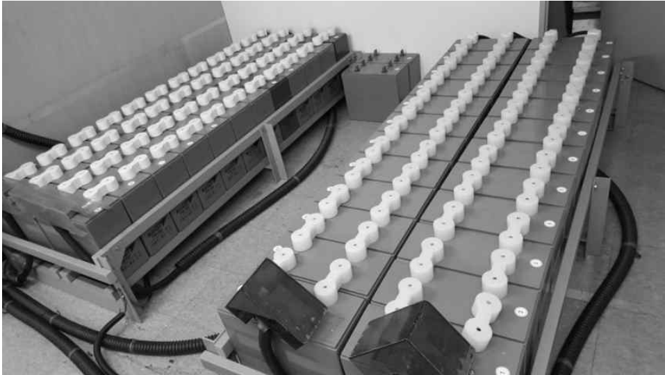
[그림 4-22] 축전지 설치 완료(예시)
