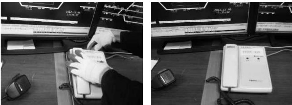
[그림 4-74] 관제전화설비 자장치 설치
