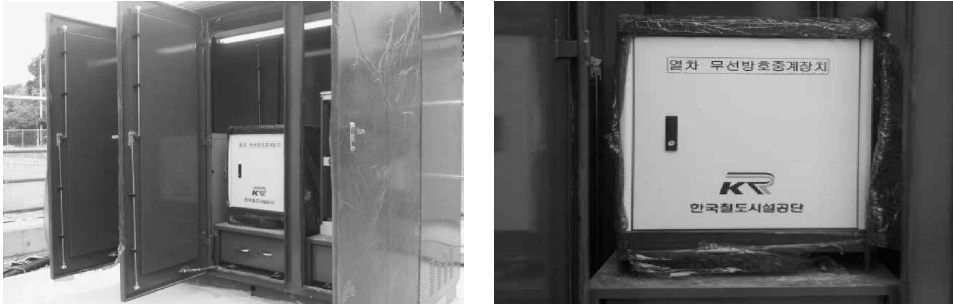
[그림 4-122] 열차무선방호 중계장치 설치 모습
