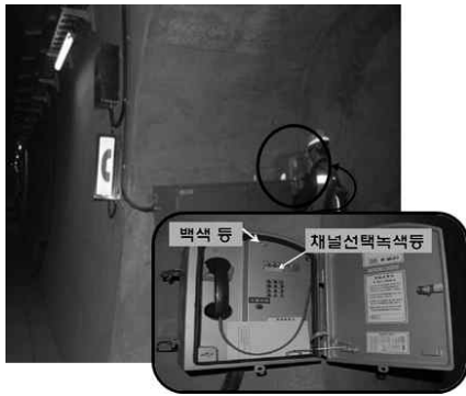
< 연선전화기 설치 현황 >
