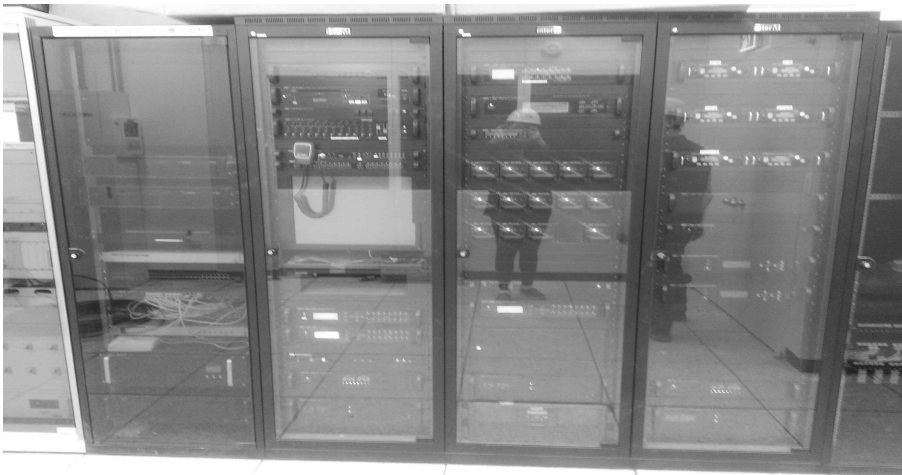
[그림 4-79] 설치된 방송설비 장비
