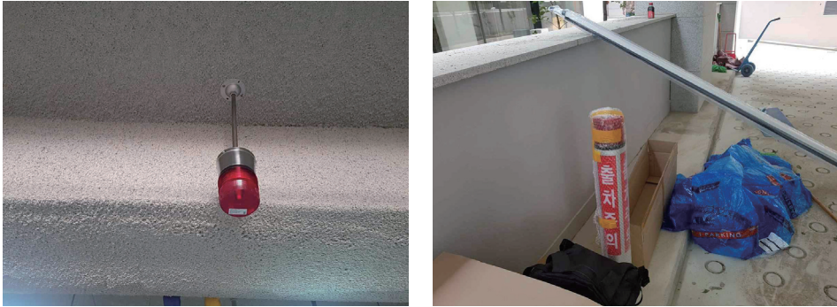
[그림 4-29] 경보등(출차주의등) 설치(예시)
