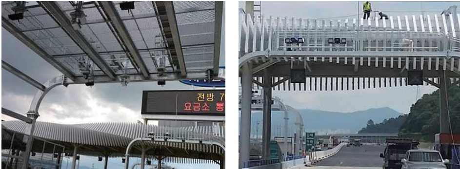
[그림 4-50] 차량검지장치 설치(예시)
