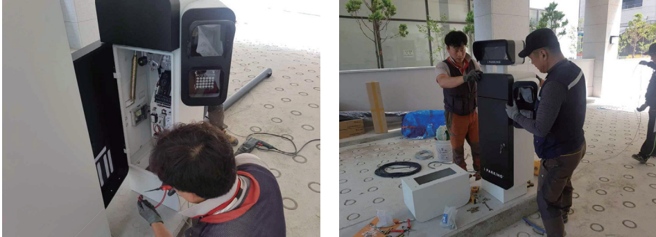
[그림 4-27] 차번인식장치 설치(예시)
