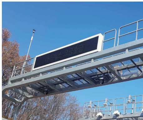
[그림 4-51] VMS 설치(예시)
