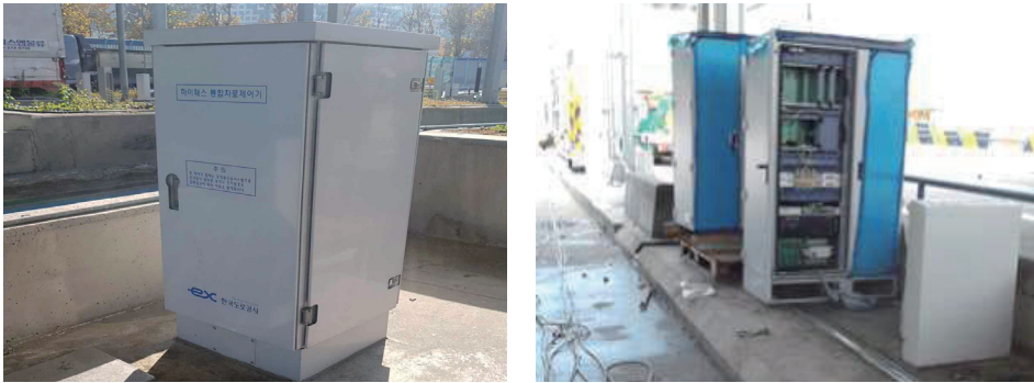
[그림 4-52] 통합차로제어기 설치(예시)
