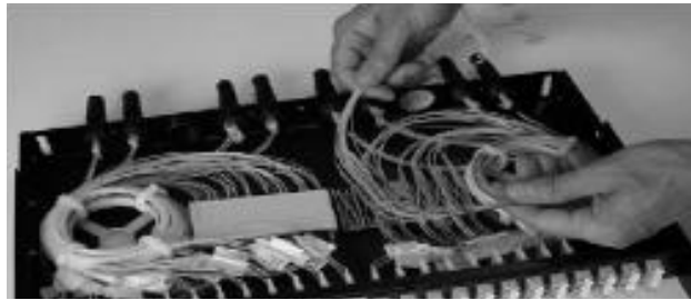
[그림 4-53] FDF 설치 (⑦ 케이블 연결)
