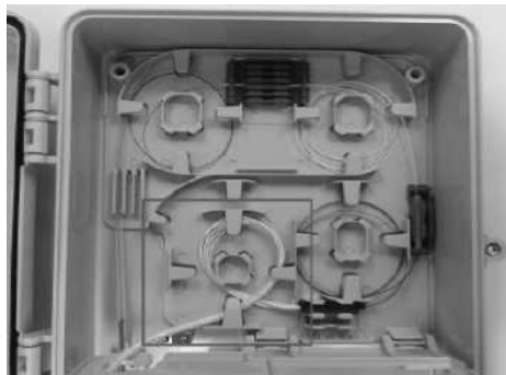
[그림 4-77] 광단자함 설치 (⑤ RN 코드 부분 트레이에 정리)
