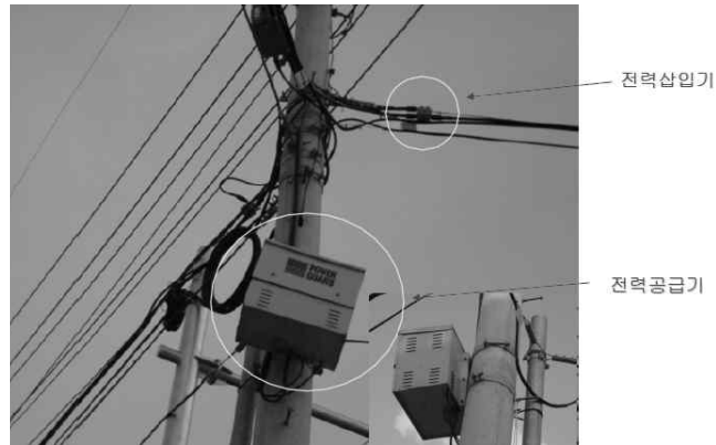
[그림 3-20] 전원공급기(PS)와 전력삽입기(PI) 설치(예)
