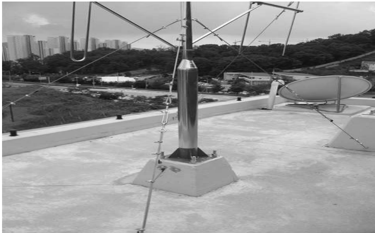
[그림 4-142] 지상파 ANTENNA설치
