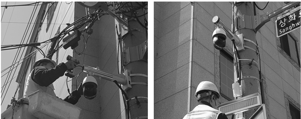
[그림 4-49] CCTV 카메라 설치(예시)
