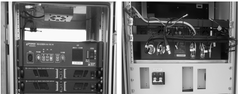
[그림 4-33] 자동수신단말기 및 방송주장치 설치(예시)
