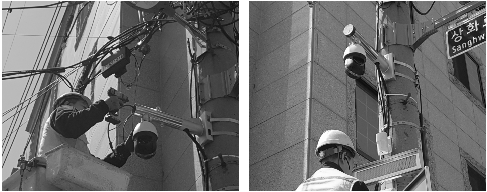
[그림 4-42] CCTV 카메라 설치(예시)
