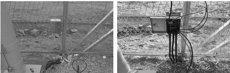
[그림 4-51] 신호분석장치 설치(예시)
