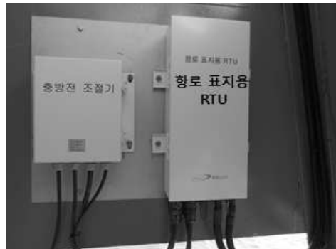
< 충방전 조절기(좌) 및 항로표지용 RTU(우) >
