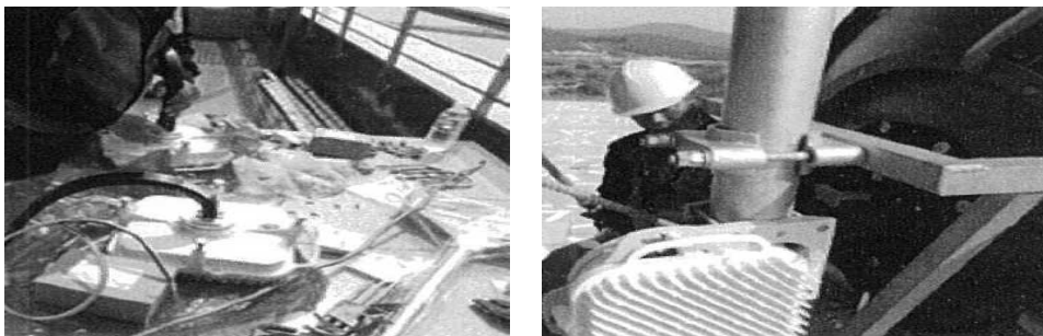
[그림 4-52] 마이크로웨이브 안테나 ODU 설치
