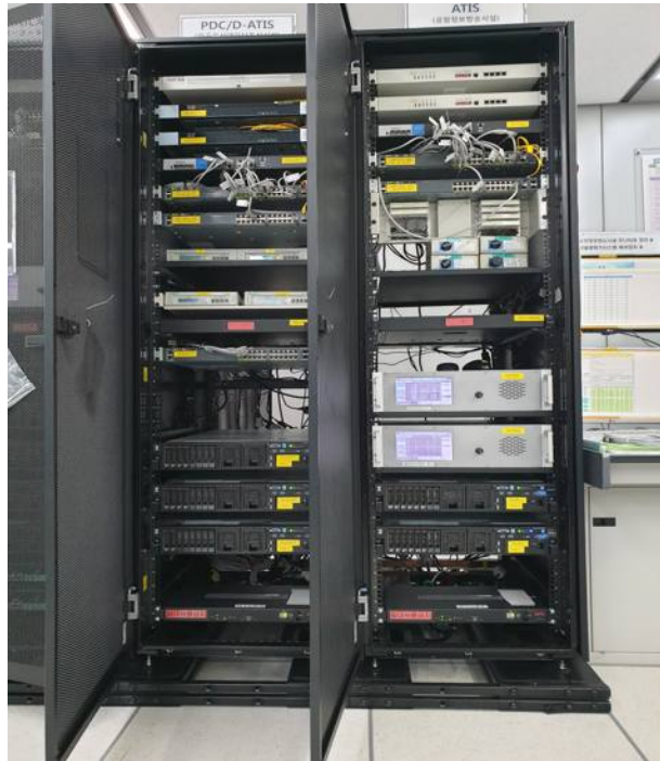
[그림 4-91] 공항정보방송시설(ATIS) 설치 완료(예시)
