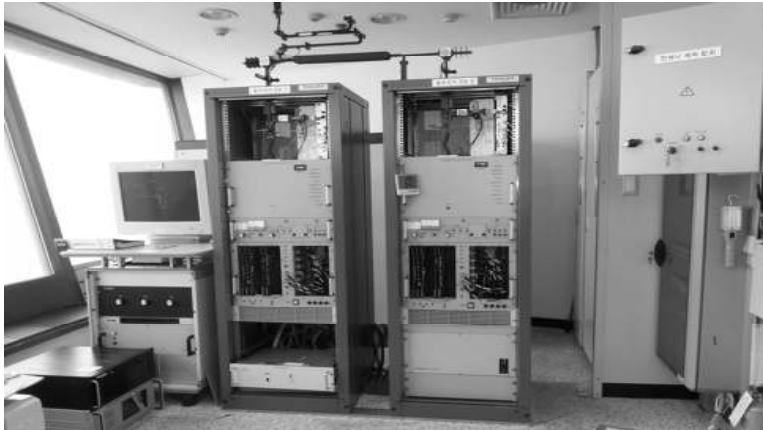
[그림 4-221] 공항지상감시레이더(ASDE) 송·수신기 설치(예시)
