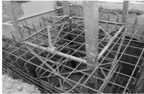
< 기초 피뢰접지 배관 및 철탑 접지 >
