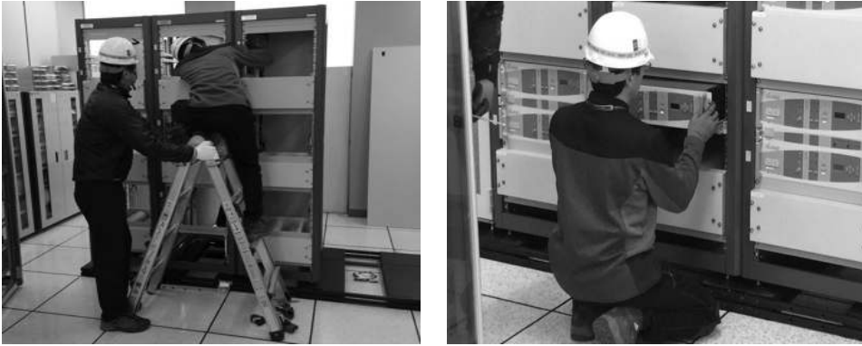
[그림 4-37] 단거리이동통신시설(VHF/UHF Radio) 랙 설치(예시)
