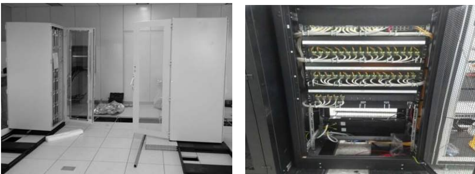
[그림 4-229] 면진장치 위에 랙 및 다변측정감시시설(MLAT) 장비 설치(예시)
