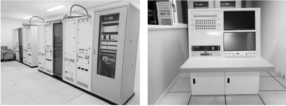
[그림 4-56] 단파이동통신시설 장비 설치 완료(예시)
