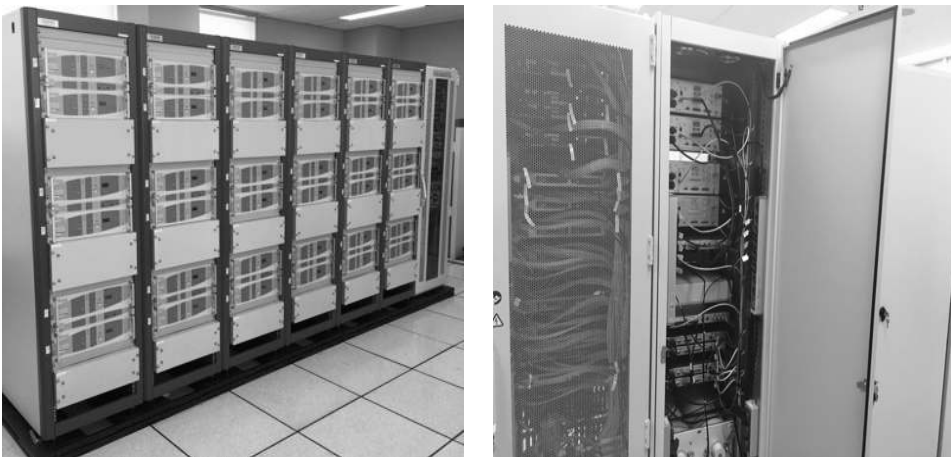
[그림 4-38] 단거리이동통신시설(VHF/UHF Radio) 장비 및 케이블설치(예시)
