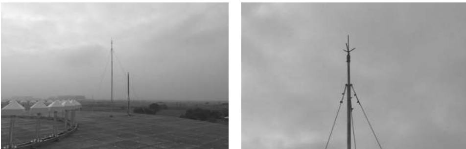
[그림 4-155] 전방향표지시설 피뢰침 설치(예시)
