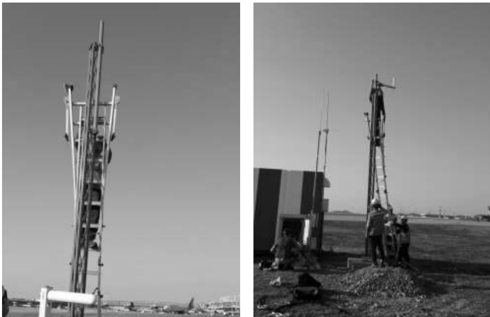
[그림 4-225] 다변측정감시시설(MLAT) 폴대 설치(예시)
