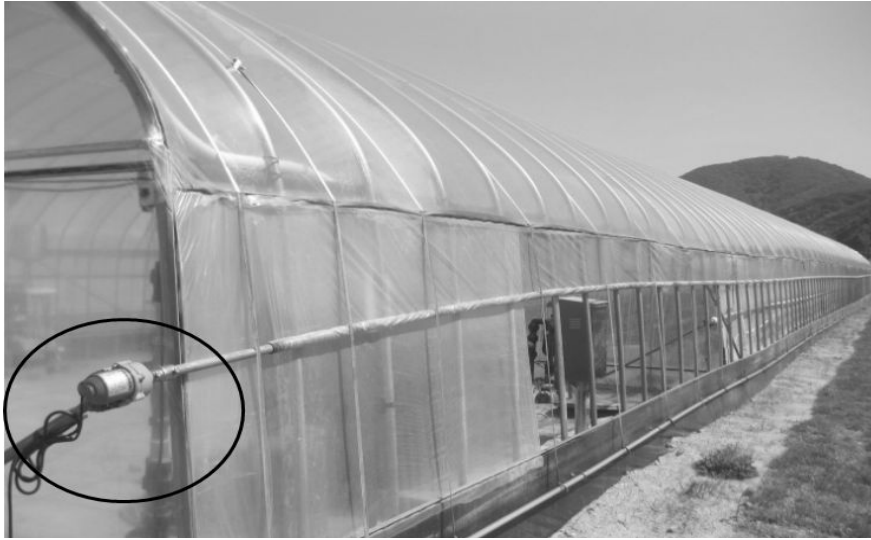
[그림 4-20] 자동개폐기 설치된 모습(예시)
