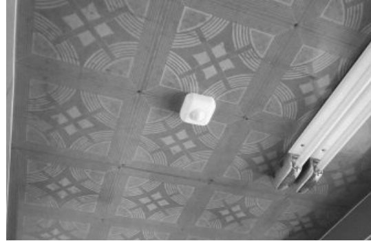
< 활동센서 설치 완료 >
