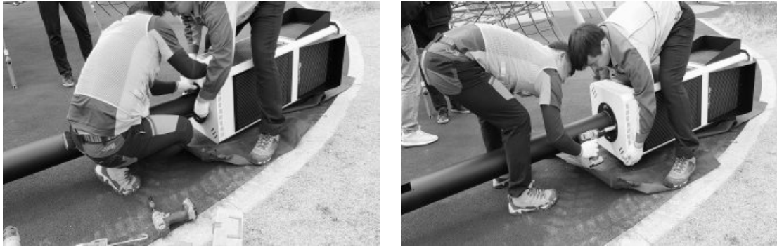
[그림 4-96] 스마트 미세먼지신호등과 철주 조립(예시)
