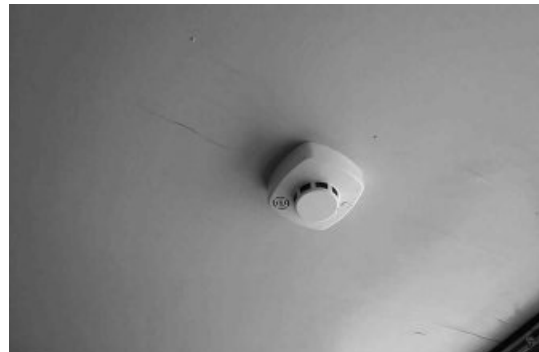
< 화재센서 설치 완료 >
