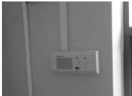
< 위급호출기 단말기 설치 완료 >
