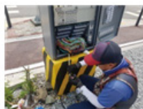
〈교통신호제어기와 케이블 결선〉
