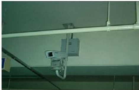
(그림 VI-10) 지하주차장내 CCTV 설치사진
