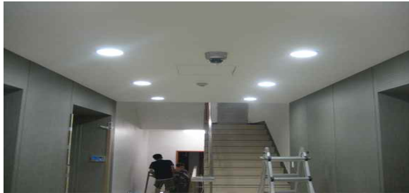
(그림 VI-9) 건물내부 CCTV 설치사진
