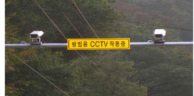
(그림 VI-17) 방범용 CCTV 설치사진
