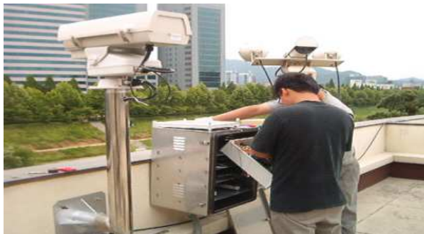
(그림 VI-16) 하천 수위감시 CCTV 설치사진
